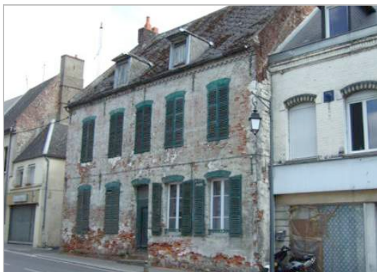
Exemples d'un bâti éprouvant des difficultés d'entretien.
